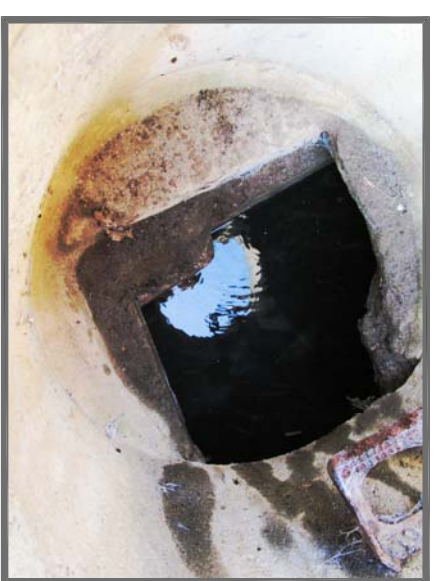
Schacht D 106.79: eingestaut
